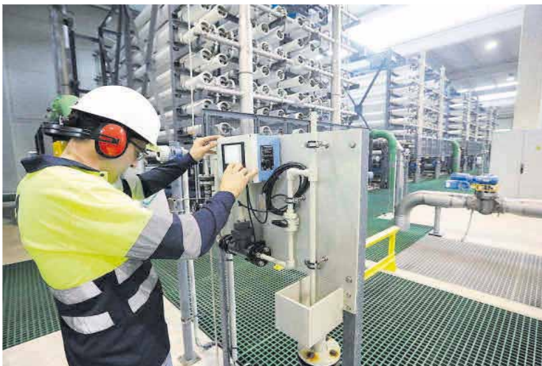
Foto de archivo de un operario trabajando en el interior de la desaladora de Orpesa-Cabanes.
